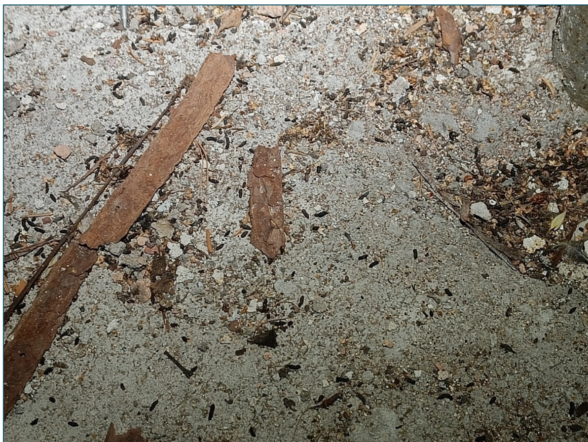
Kuva 5. Runsaasti lepakoiden ulosteita vanhainkodin ullakon lattialla.
