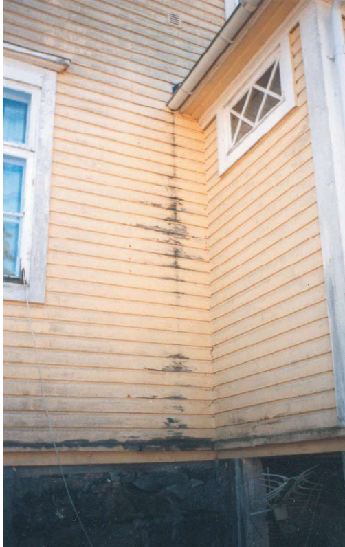
Korjaustoimenpiteet kannattaa aloittaa vaurion syyn poistamisella
